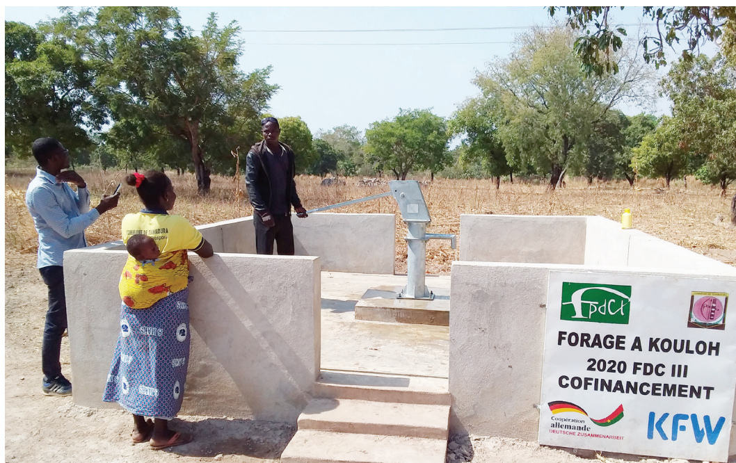
Réalisation de deux forages positifs dans les villages de Dangbara et Kouloh dans la commune de Tiankoura
