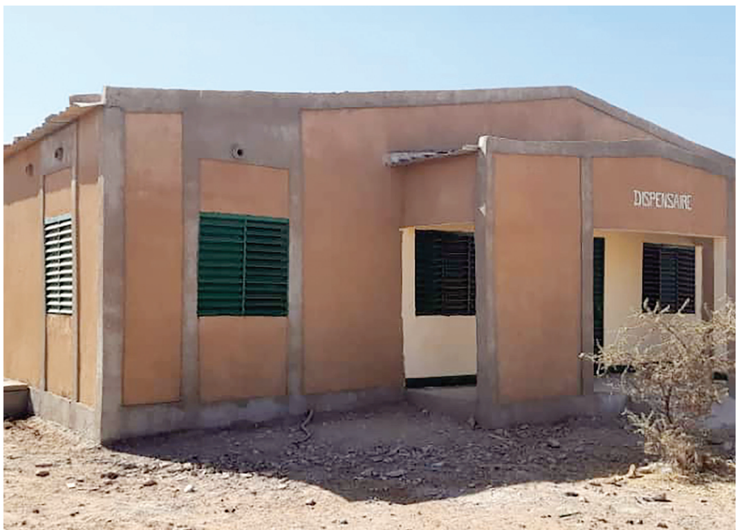
Construction d'un Centre de santé et de promotion sociale (CSPS) à Zargaloutan dans la Commune de Falagountou
